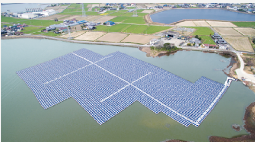
水上ソーラーシステム
