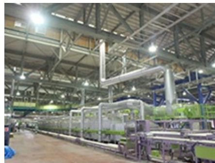
ベルバーン成形工場LED照明
