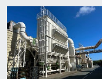
木工集塵機 (高効率機器への変更)
