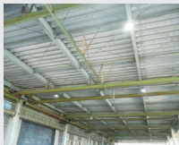
第2ヤード蛍光灯LED化
